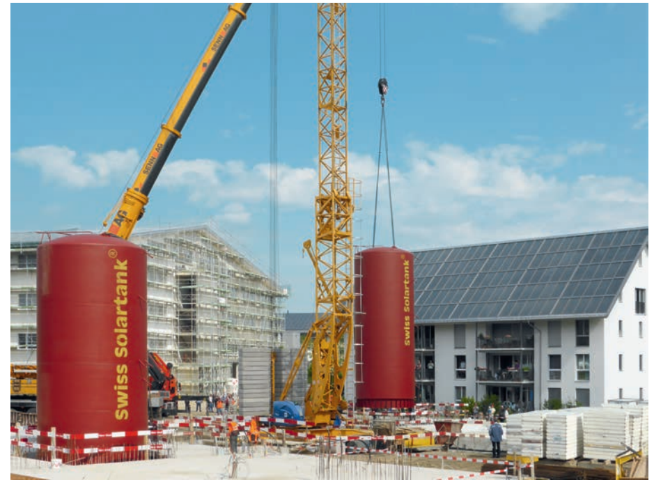
Saisonspeicher für ganzjährige Wärmeversorgung von zwei MFH
